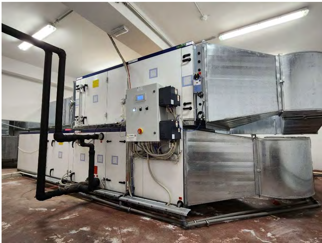
Figura Error! No text of specified style in document..15 – Centrala de tratare a aerului CTA (AHU)
