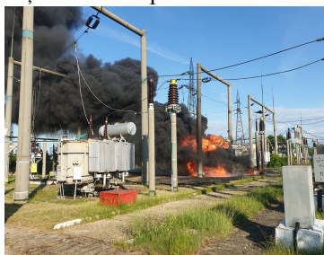
Fig. 10. Incendiu recent la un transformator în Adjud, Vrancea
